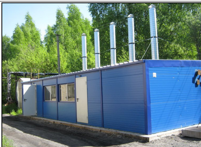
Рисунок 1.2.3. БМК №9 ул. Набережная,72
